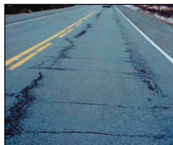
Fissuration en fatigue
